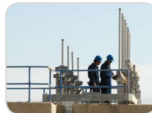
مبنى التحكم بالتدفق Flow Control Chamber
