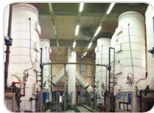
مبنى معالجة الروائح Odor Control Building
