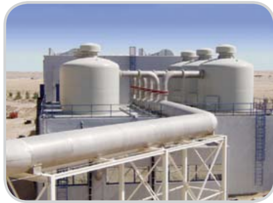
غرفة إضافة الكلور Chlorination Dosing Room
