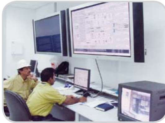
مركز التحكم في مبنى الإدارة Control Center at Administration Building
