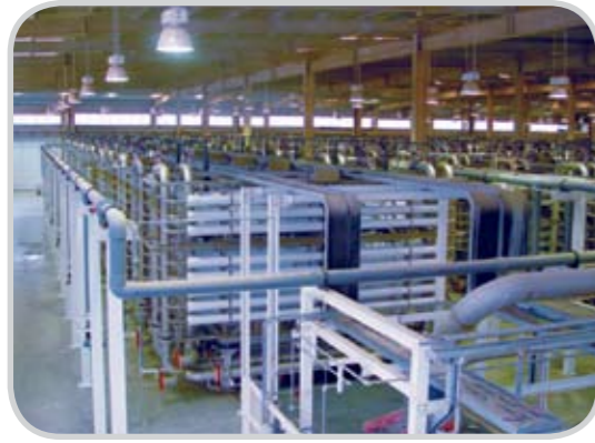
مبنى الفلترة فائقة الجودة Ultra - Filtration Building
