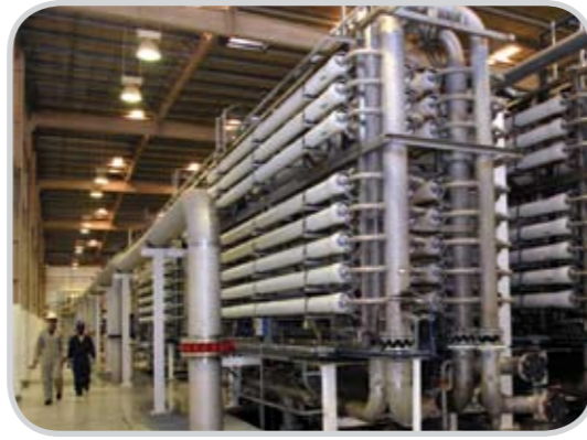
مبنى الفلترة فائقة الجودة Ultra - Filtration Building
